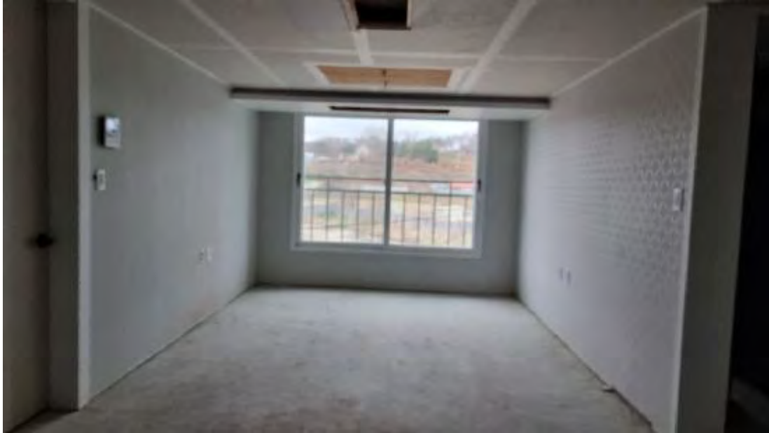
제에이동 제1호 라인 내부 전경
