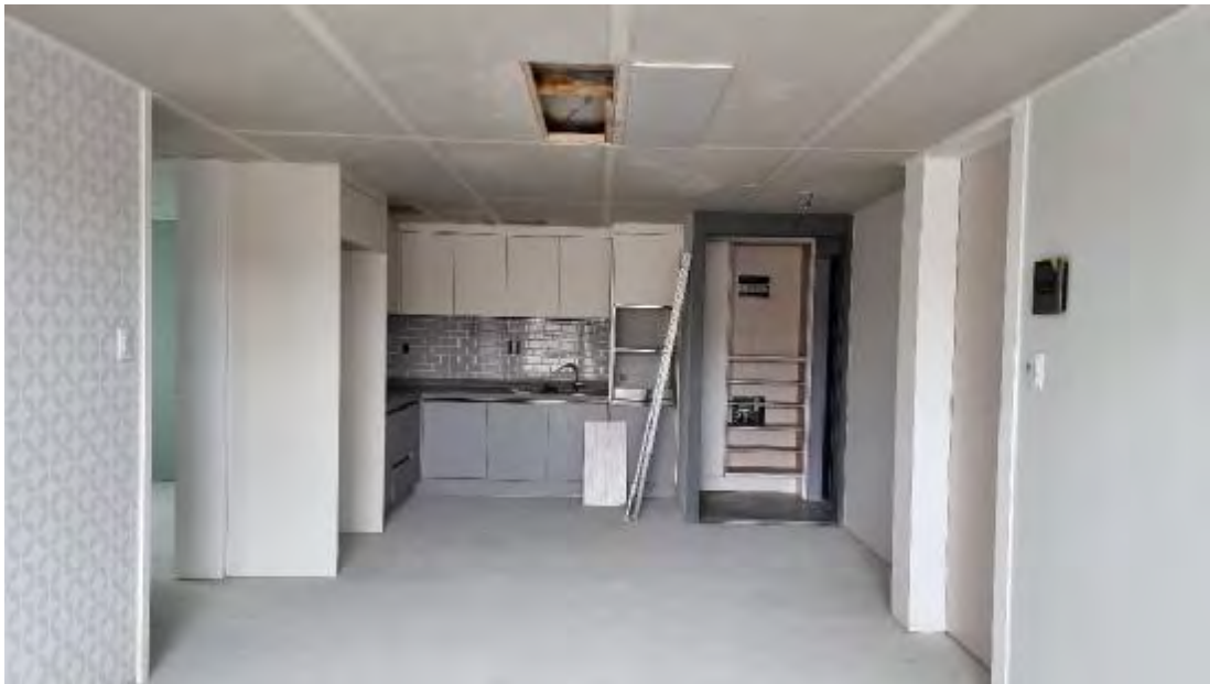
제에이동 제1호 라인 내부 전경
