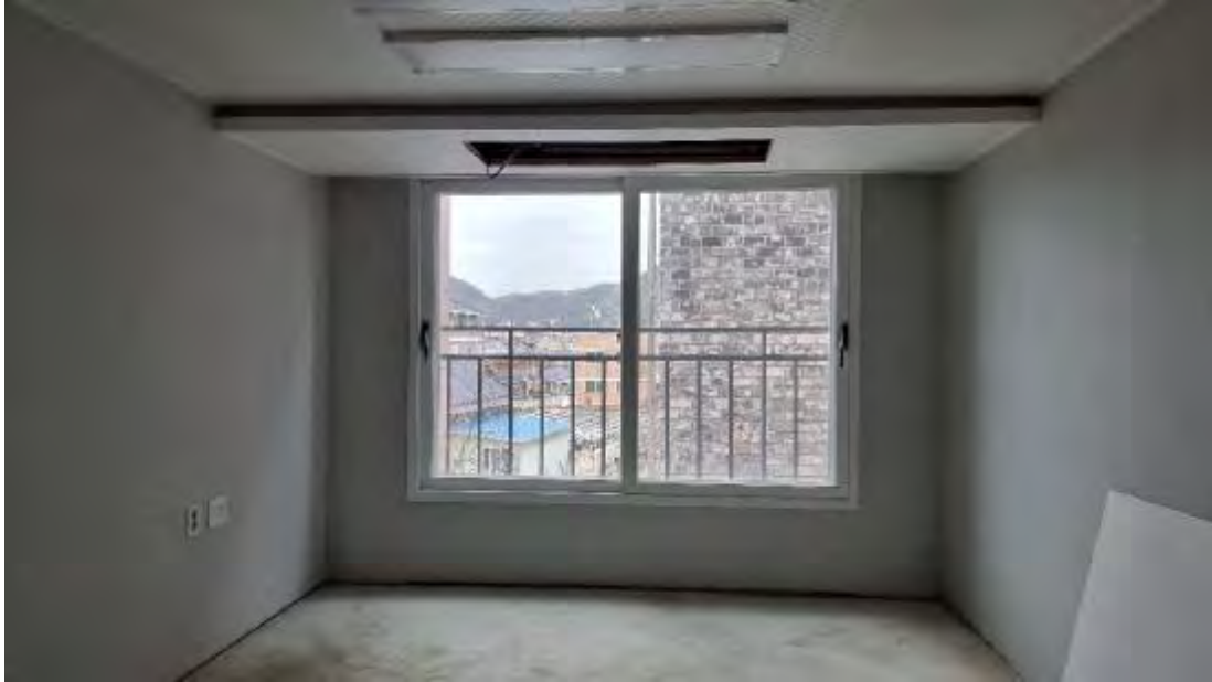
제에이동 제2호 라인 내부 전경
