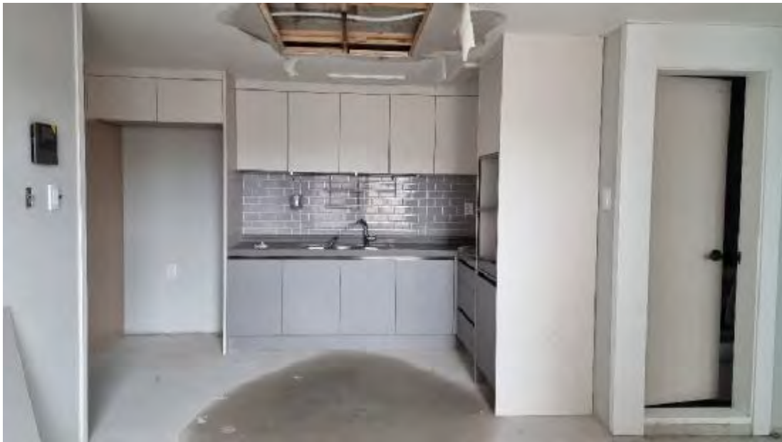
제에이동 제2호 라인 내부 전경
